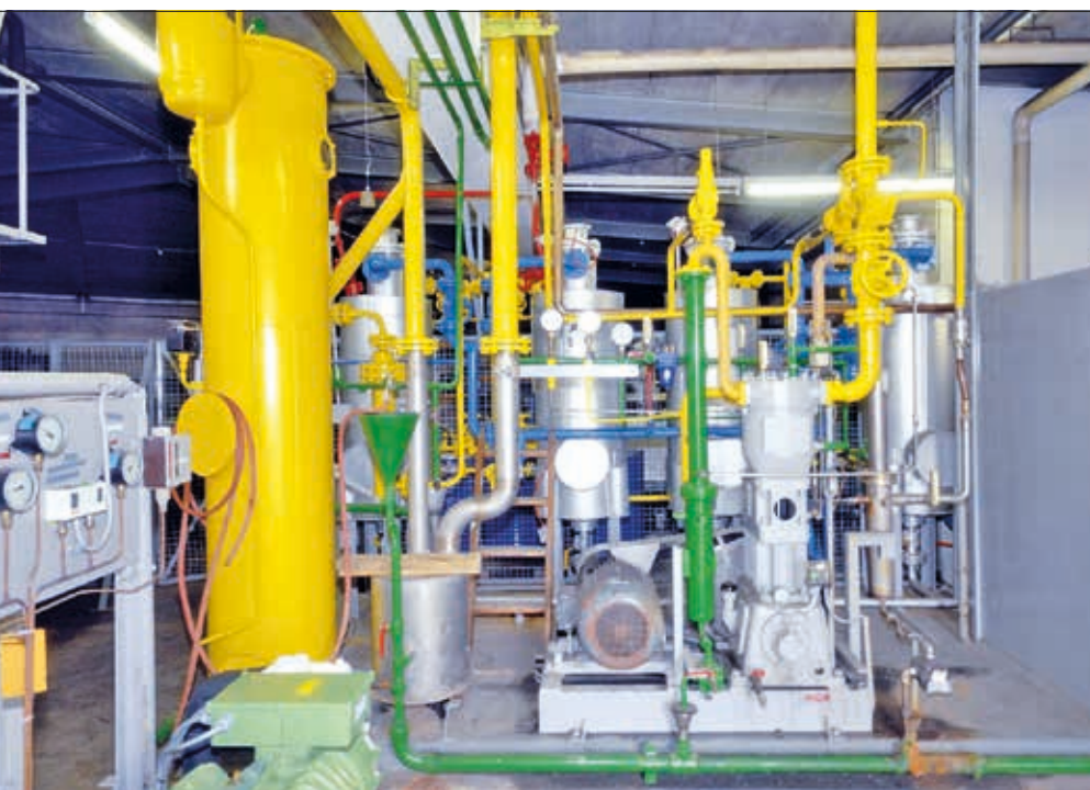
CO 2 -Rückgewinnung in einer Brauerei, seit 40 Jahren in Betrieb
