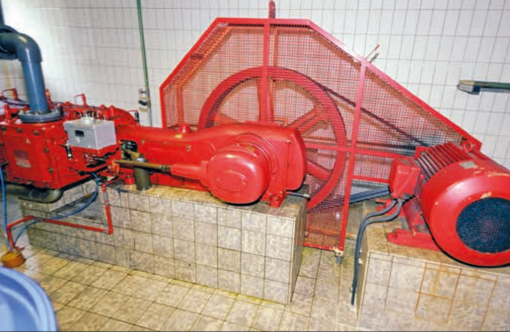
Seit Jahrzehnten im Einsatz: Kompressor für die CO 2 -Gewinnung aus Brunnenwasser in einem Mineralwasserbetrieb
