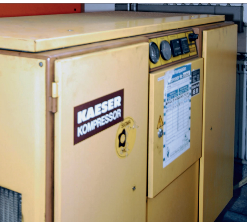
Abb. 1: Druckluftstation: Installiert und dann vergessen? Wie verändern sich Wirkungsgrad und Leckluftmenge über Jahrzehnte „unbekümmerten“ Betriebs?
