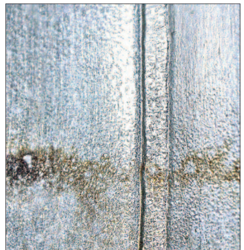
Abb. 11: Ausführung CC, Korrosion am Flüssigkeitsspiegel
