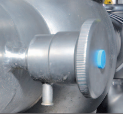
Abb. 2: Mit „Aufwand“ falsch montiertes Probenahmeventil
