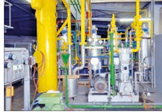
CO 2 -Rückgewinnung in einer Brauerei, seit 40 Jahren in Betrieb
